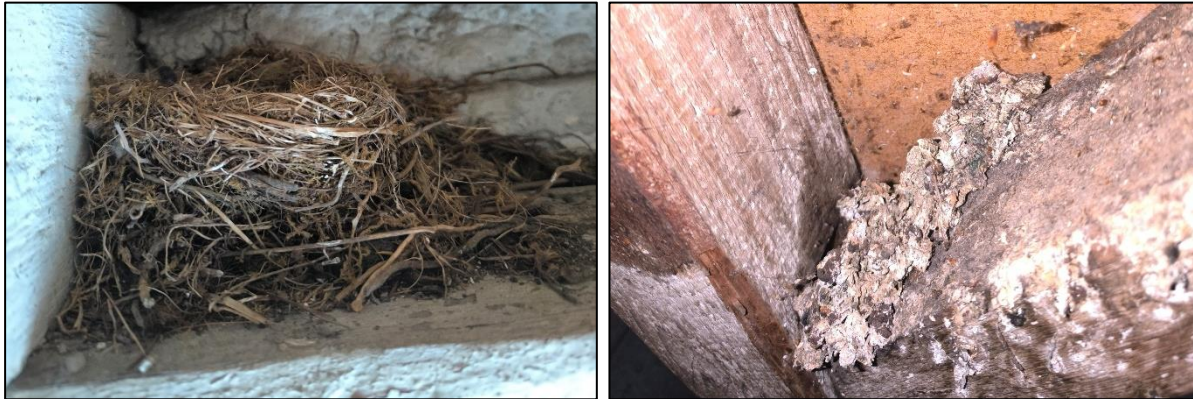
Abbildung 8: Nestfund auf dem Dachboden der Ludwig-Herr-Straße 16/1 (linkes Bild, vermutlich Hausrotschwanz) sowie Kotspuren auf dem Dachboden der Ludwig-Herr-Straße 16 (rechtes Bild).
