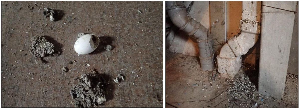
Abbildung 9: Taubenei und Kot auf dem Dachboden des Hauses in der Ludwig-Herr-Straße 34 (linkes Bild) sowie Kots Spuren auf dem Dachboden des Hauses in der Zeppelinstraße 42 (rechtes Bild).
