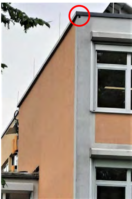
Abb. 43: Ein 2022 nicht belegter Hohlraum an der Fassade/Westseite Schulgebäude
