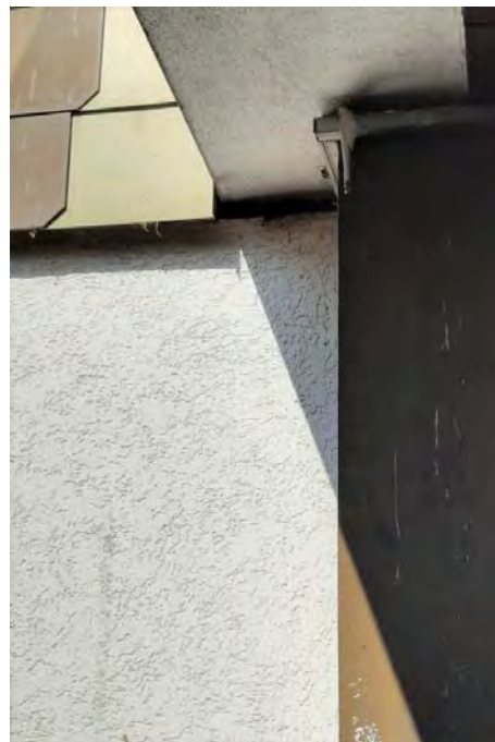
Abb. 14: Der Haussperling nutzt eine Vielzahl von Hohlräumen an den Fassaden als Brutplatz
