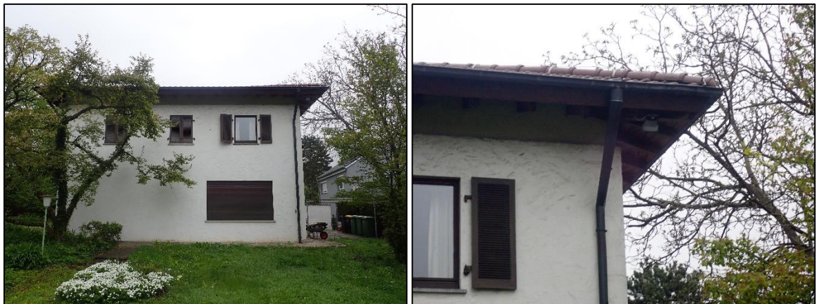
Abbildung 6: Blick von Süden auf das Wohngebäude der Weimarstraße 9 mit hölzernen Fensterläden (linkes Bild) und schmalen Spalten im hölzernen Dachüberhang (rechtes Bild).
